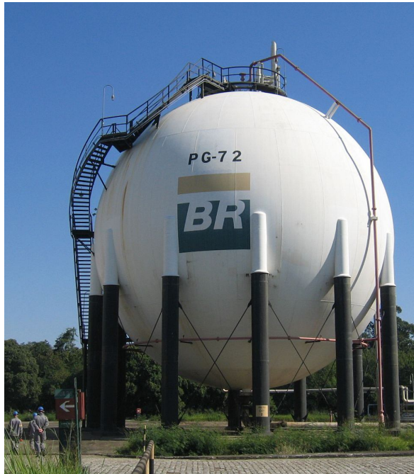
Figura 10 – Esferas de armazenamento de gás natural
