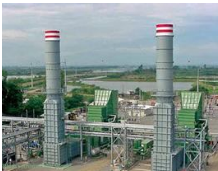
Figura 15 – Turbina a gás natural
