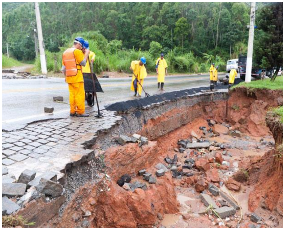
Figura 7: Erosão em estradas.
